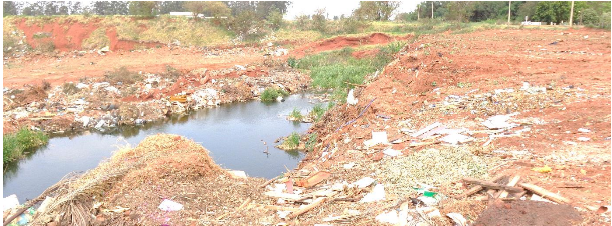
Figura 49 – Afloramento de lençol freático no local de disposição de RLP no município de Naviraí/MS.
