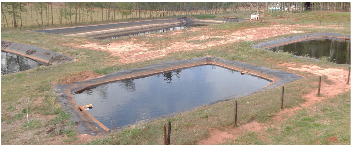
Figura 41 – Sistema de tratamento de percolato (chorume) do aterro sanitário em Naviraí/MS.
