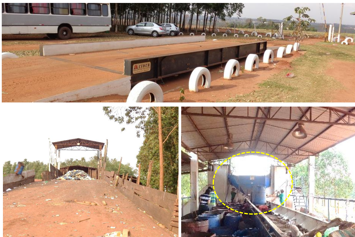
Figura 26 – Balança rodoviária, rampa para disposição dos resíduos e funil que liga a rampa à esteira. Fonte: Deméter Engenharia Ltda., 02/09/2014.
